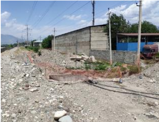
Фотография 1: Не установлены предупреждающие знаки, май 2021 года
