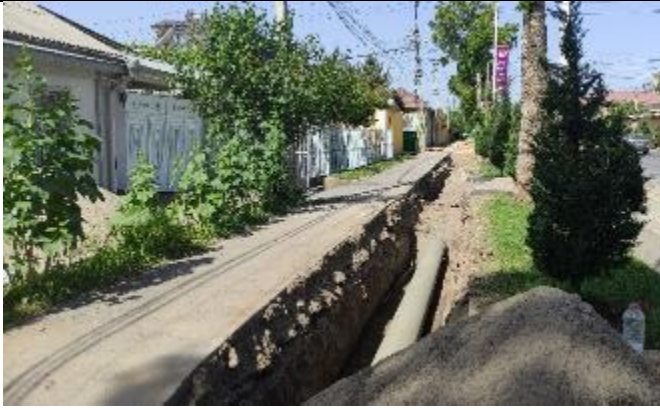
Фото 25: CW04 участок 1 Не установлена сигнальная лента вокруг траншей
