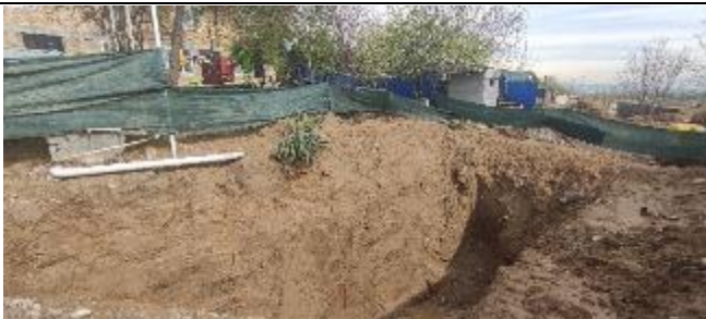
Фото 31: CW-03 Лот 2 Защитные ограждения не установлены
