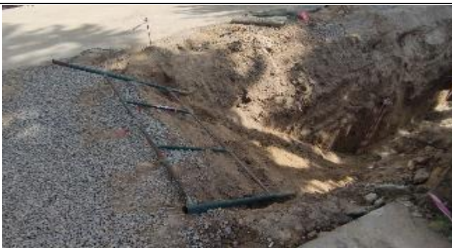
Фото 29: CW-01 лот 2 Установленные шламбаумы ненадежны, минимальный шаг
