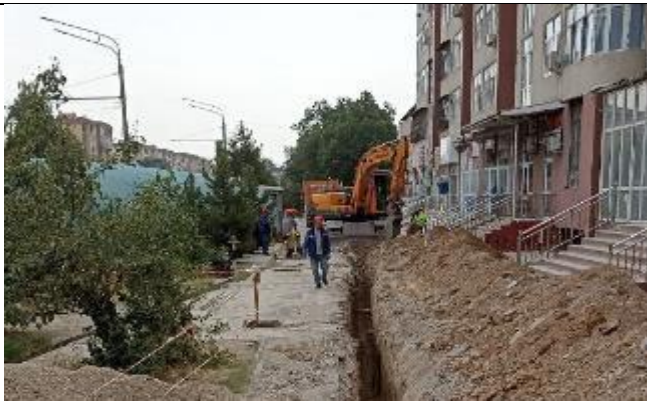
Фото 27: КС-04 Лот 2 Отсутствие мостов через траншеи
