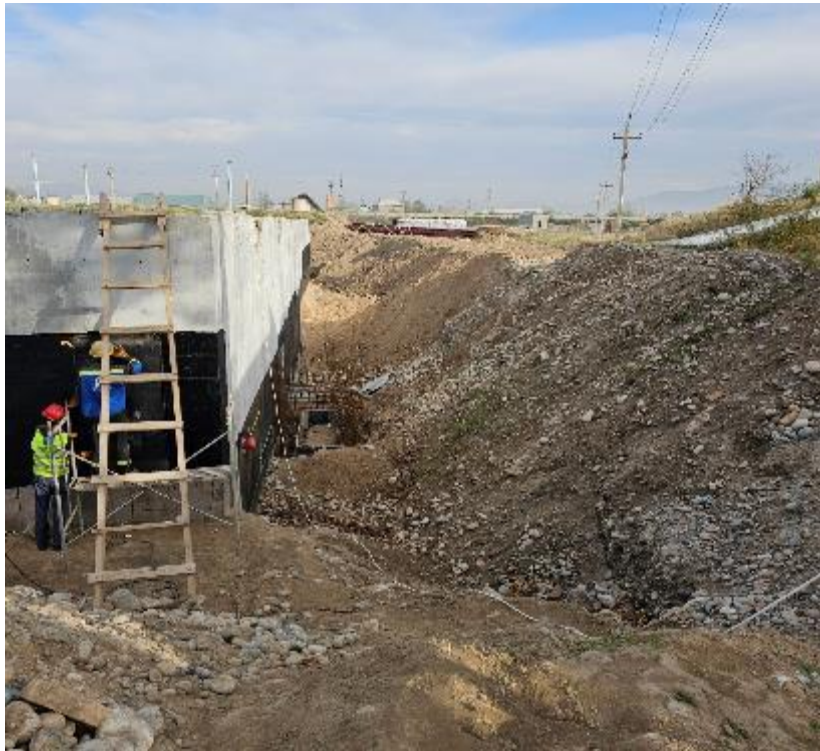
Фото 48: SW01 лот 1 - Небезопасная деревянная лестница 27 ноября 2023
