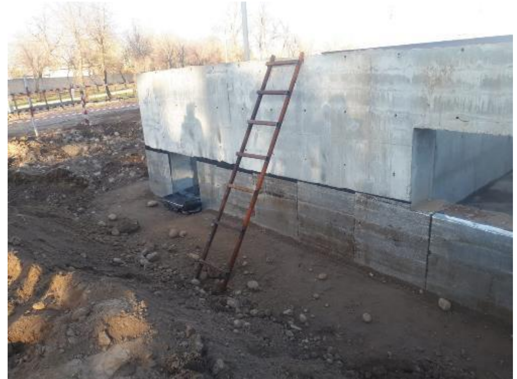
Фото 49: SW01 лот 1 - Стальная безопасная лестница предоставлена подрядчиком
