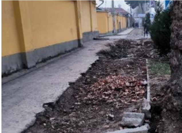
Фото 40: Состояние тротуаров до реставрации
