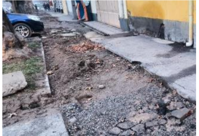
Фото 41: Состояние тротуаров до реставрации
